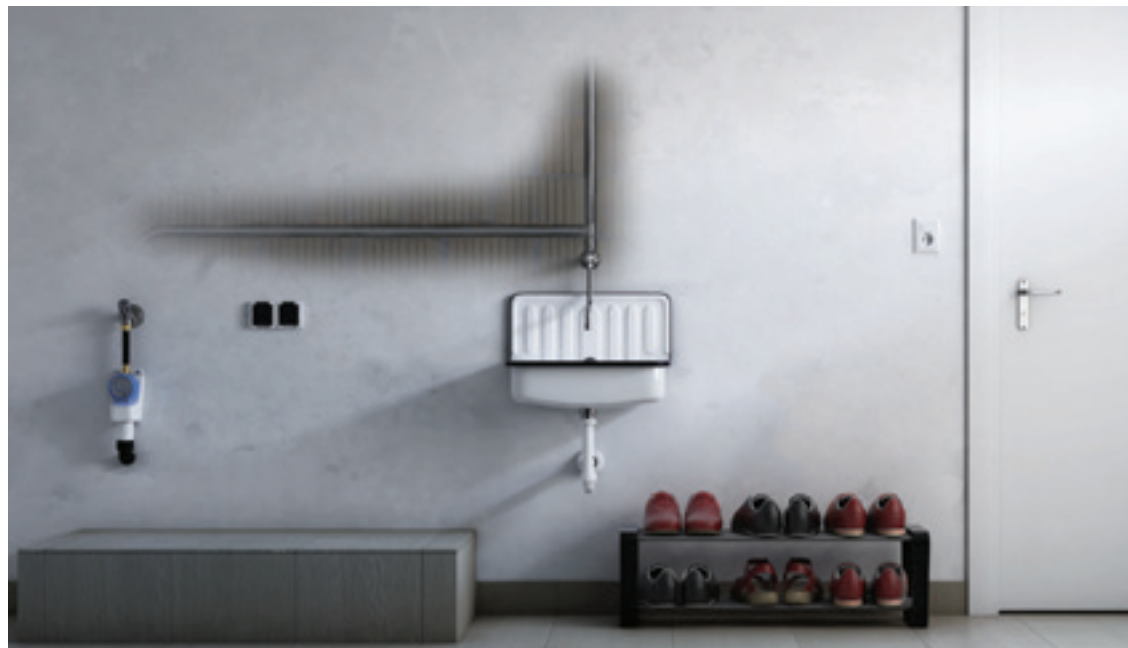
↑ VOORBEELD: DOODLOPENDE, ONGEBRUIKTE LEIDINGEN
